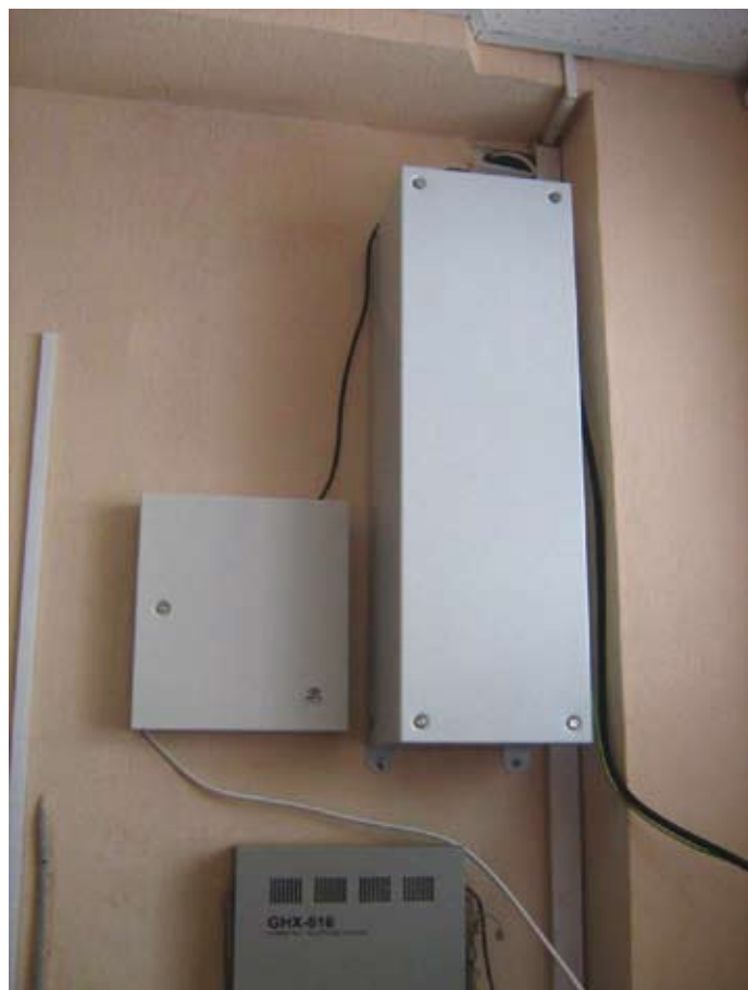
Размещение ретранслятора исп.1 с блоком фильтров
